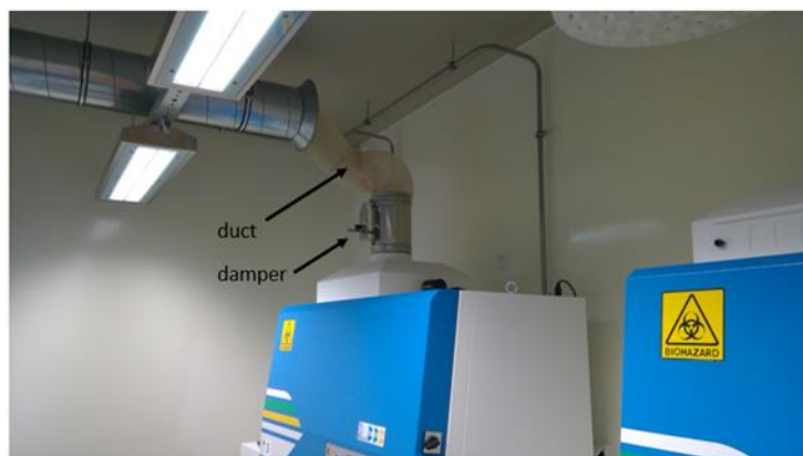
Figura 3: Sistema aperto su una cappa canalizzato
